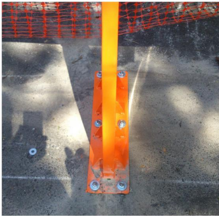
Figura 18 - Apoio instalado e fixo da Estação.
