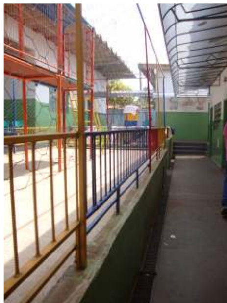
Foto 9 – Cobertura que será substituída para proteção contra chuva.
