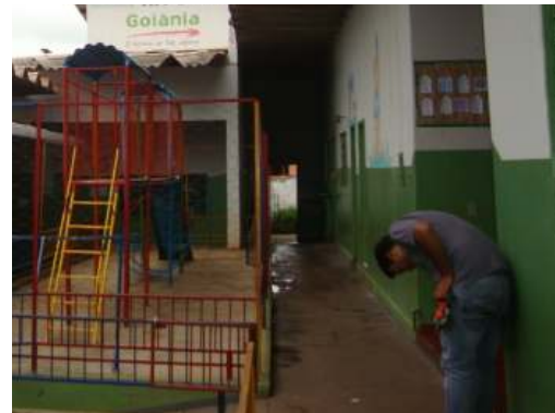
Foto 4 – Revestimento cerâmico a ser substituído.
