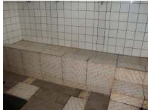
Foto 2 - Revestimento cerâmico a ser substituído.
