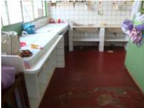
Foto 1 – Revestimento de cimento queimado a ser substituído.
