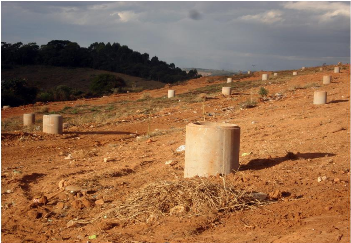
Foto 1 – drenos de gás em aterro sanitário (fonte: Internet)
