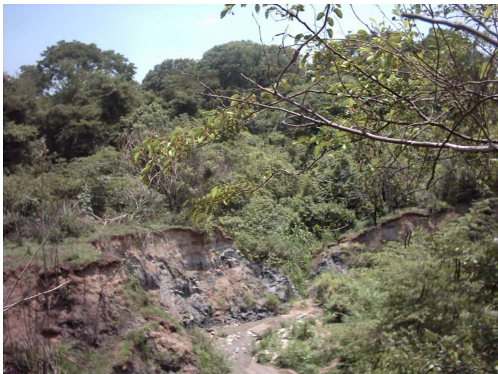
Figura 8.09: Imagem da erosão por solapamento do Córrego Retirinho, no Setor de Chácaras Pedroso, a jusante da área da Cooperativa de Reciclagem de Lixo (COOPREC).
