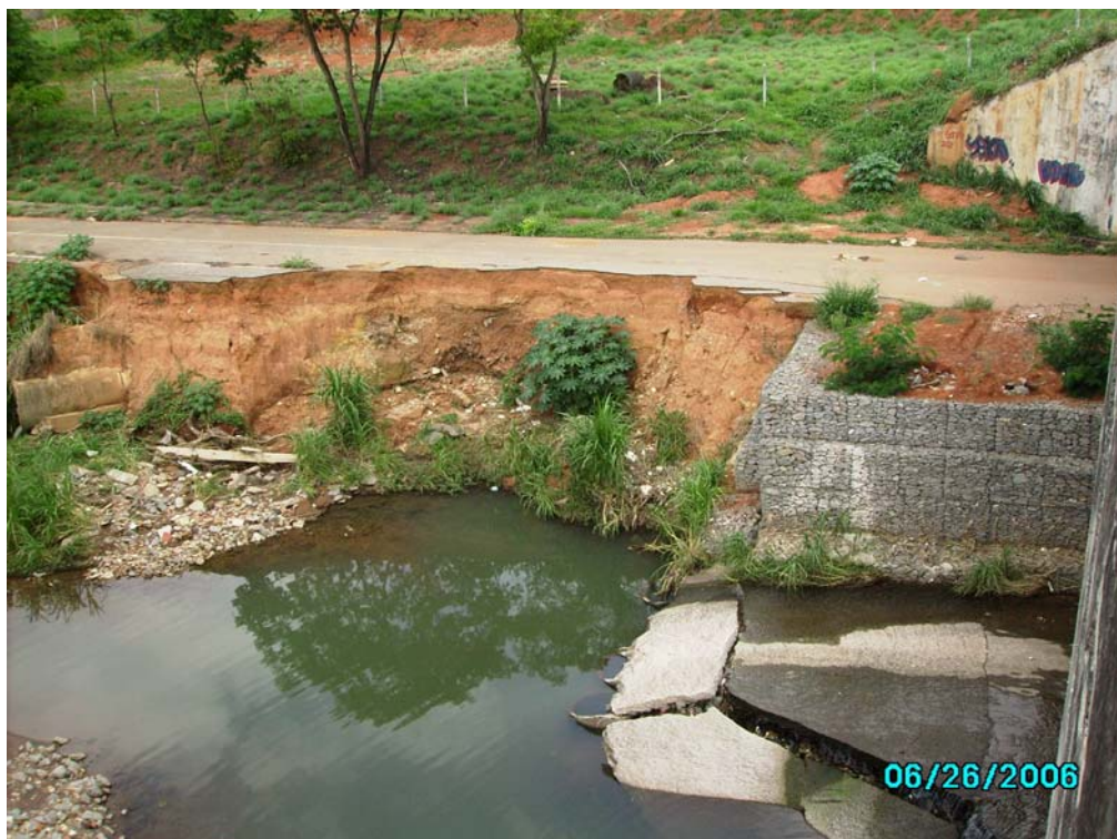
Figura 8.41: Erosão da Avenida Marginal do Córrego Cascavel, abaixo da ponte da Avenida T-63.
