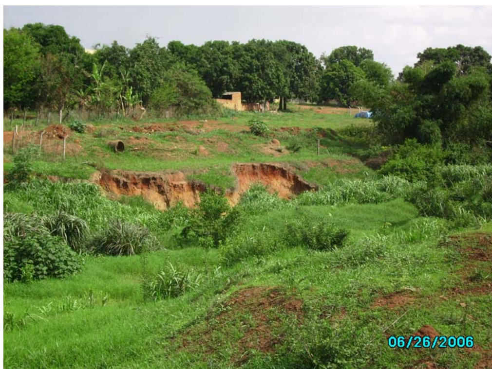
Figura 8.36: Erosão por solapamento das margens do Córrego Macambira, acima da Avenida Milão, no Setor Celina Park.
