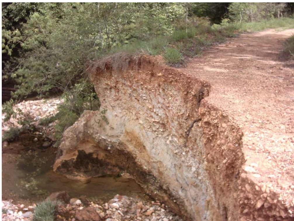
Figura 8.63: Material aluvionar com erosão das margens da drenagem por solapamento, em trecho situado à jusante da erosão do autódromo.
