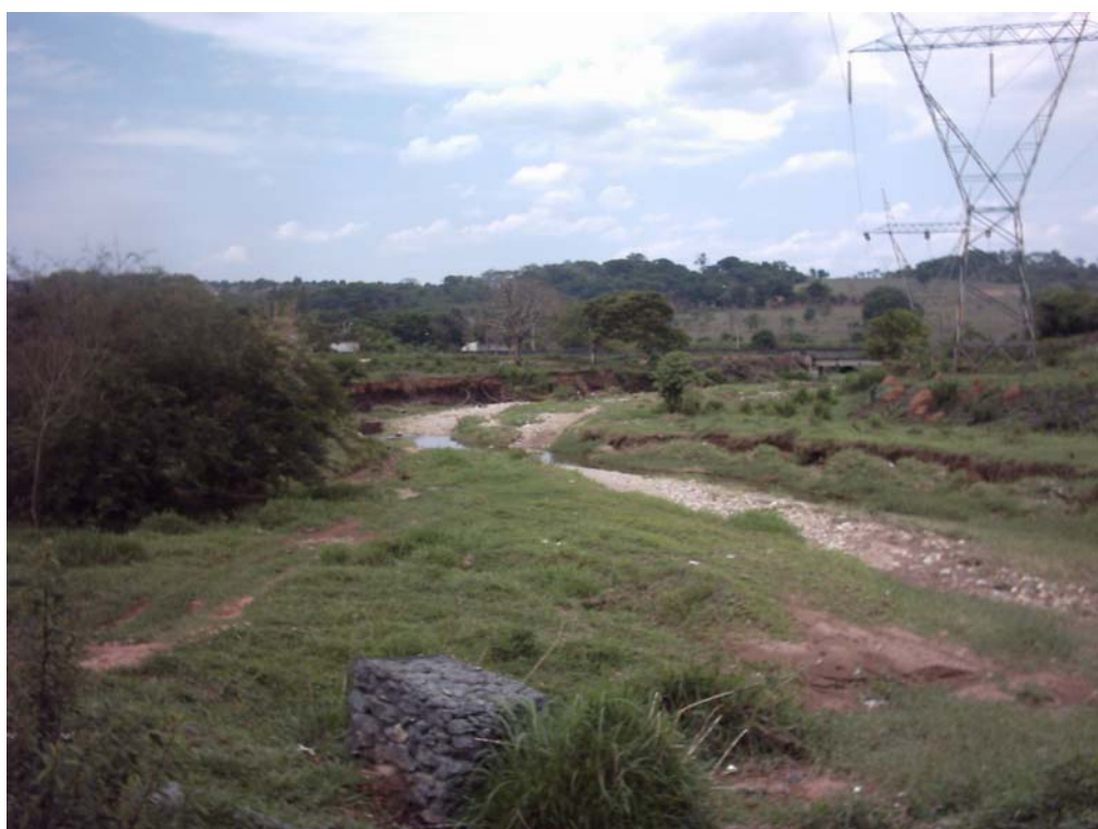
Figura 8.16: Uma vista panorâmica da erosão vista no ponto anterior, observando-se à direita, duas torres de transmissão de linha de alta tensão ameaçadas pelo processo erosivo. O local situa-se na região da Depressão do Rio Meia Ponte.
