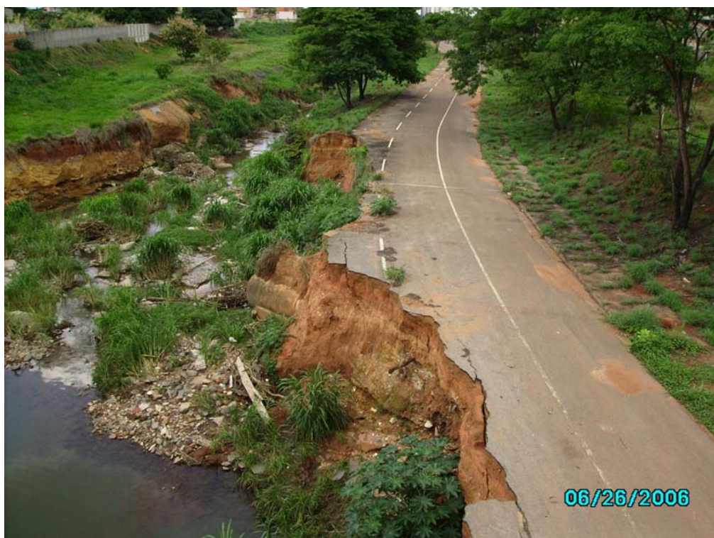
Figura 8.42: Uma vista de cima da ponte da erosão do Córrego Cascavel, abaixo da ponte da Avenida T-63.
