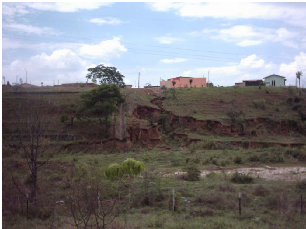
Figura 8.13: Erosão por ravinamento das margens do Córrego Água Branca entre o Conjunto Aruanã II e o Jardim Califórnia.
