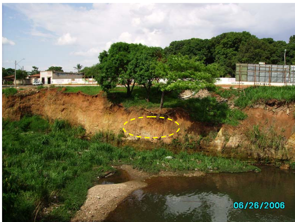
Figura 8.37: Erosão abaixo da passagem do Córrego Macambira, na Avenida Milão, Setor Celina Park, ameaçando a via marginal. No centro da imagem uma árvore com raízes expostas.
