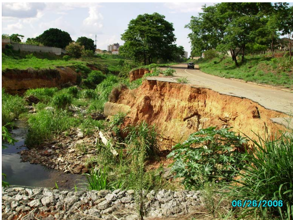
Figura 8.43: Detalhe da erosão da Avenida Marginal do Córrego Cascavel. Na parte inferior da imagem restos de muro de arrimo/gabião levado pela enxurrada.
