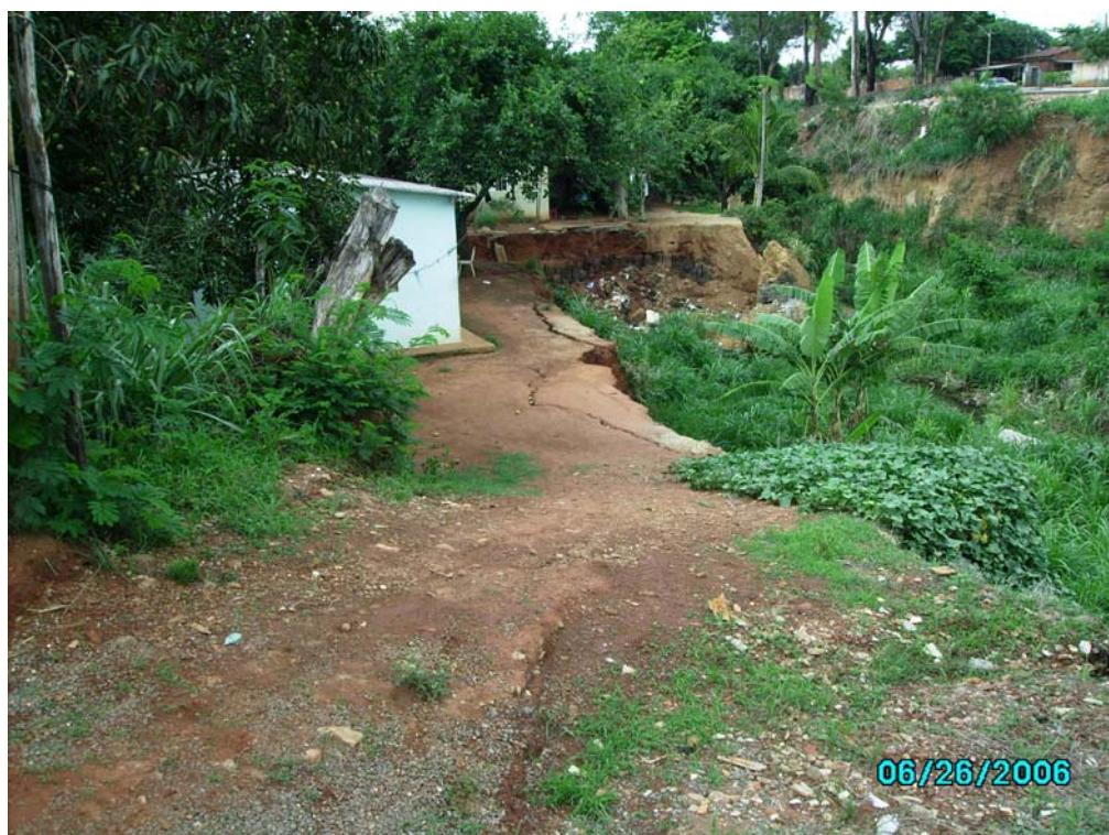
Figura 8.38: Uma imagem do mesmo local, na outra margem, onde podem ser observados pontos de ruptura do maciço, ameaçando moradias construídas no fundo do vale.
