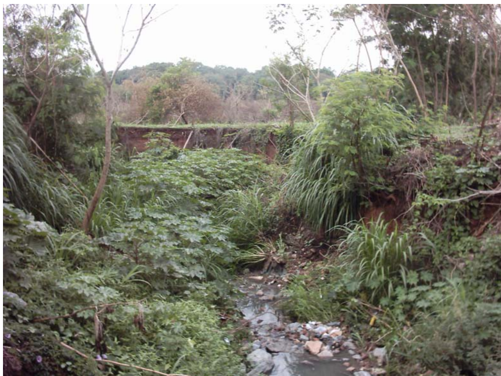
Figura 8.01: Imagem de erosão pluvial observada no final da Rua 406, Setor Negrão de Lima.
