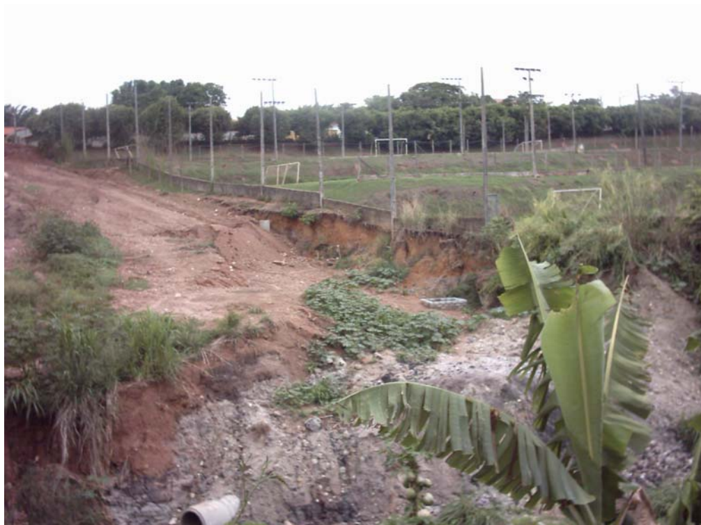
Figura 8.21: Continuação da imagem anterior, tomada da Rua Uruguai, Jardim Novo Mundo, onde se observa processo erosivo por ravinamento na margem do Córrego Água Branca.
