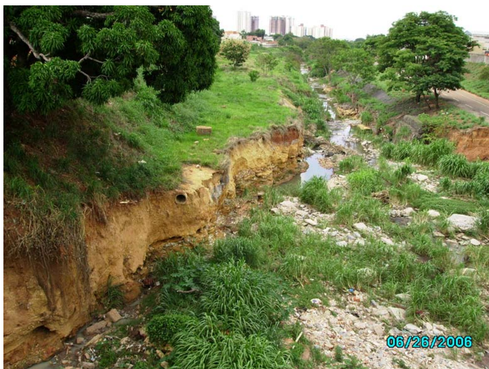
Figura 8.40: Um dos pontos de erosão por solapamento do Córrego Cascavel, abaixo da ponte da Avenida T-63.
