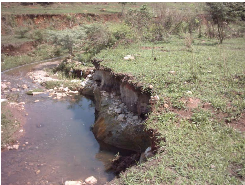
Figura 8.06: Processo erosivo por solapamento das margens do Córrego Palmito próximo à sua foz no Rio Meia Ponte. No local ocorre afloramento de gnaiss granulítico.
