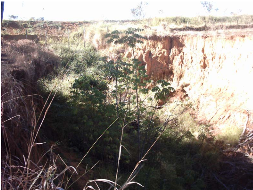
Figura 1.07: Vista de detalhe da erosão do tipo 3 (voçoroca), cadastrada na região centro - oeste da macrozona, vizinho ao condomínio Goiânia Golf Residence .
