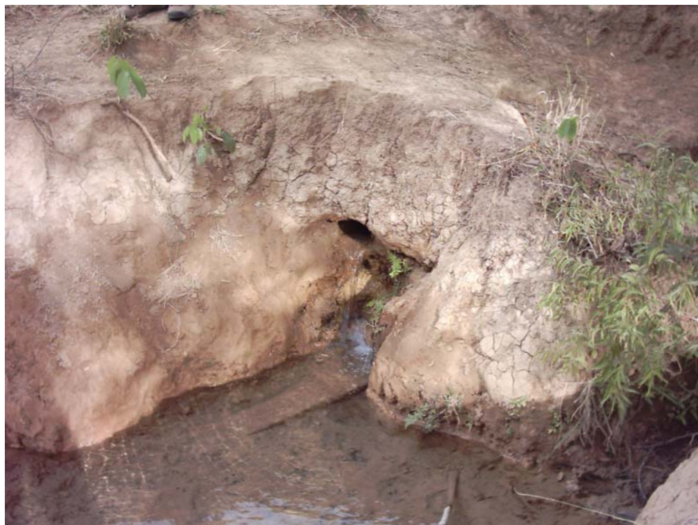
Figura 1.10: Detalhe de outra surgência, situada um pouco mais ao sul, no limite sudoeste da macrozona. Diferente da primeira, esta surgência, pelo seu aspecto, sugere que a concentração do fluxo esteja condicionada a um piping .
